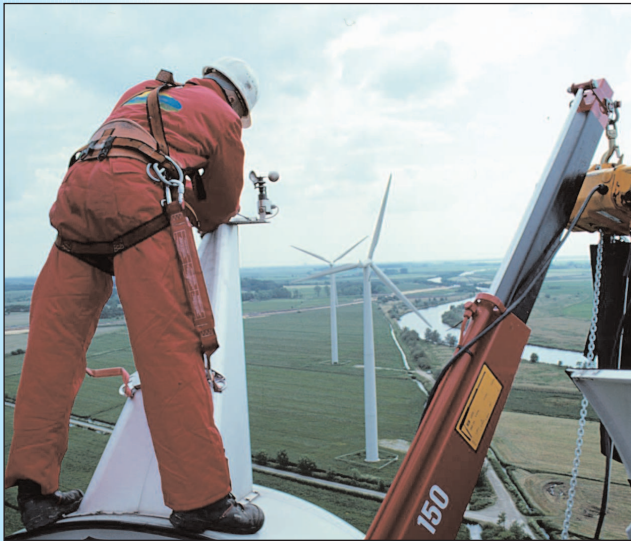
Ein Reetec-Mitarbeiter bei der Überprüfung und Kalibrierung einer Windfabne Fotos: Reetec
